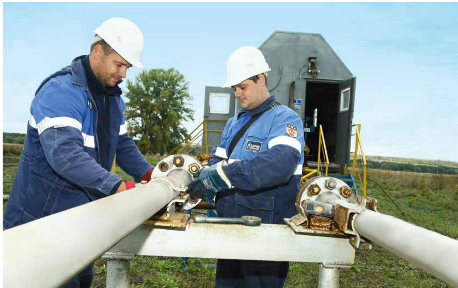
Операторы по добыче нефти и газа Виталий Загребин (слева) и Рустам Муслимов приступили к демонтажу входных и выходных трубопроводов
