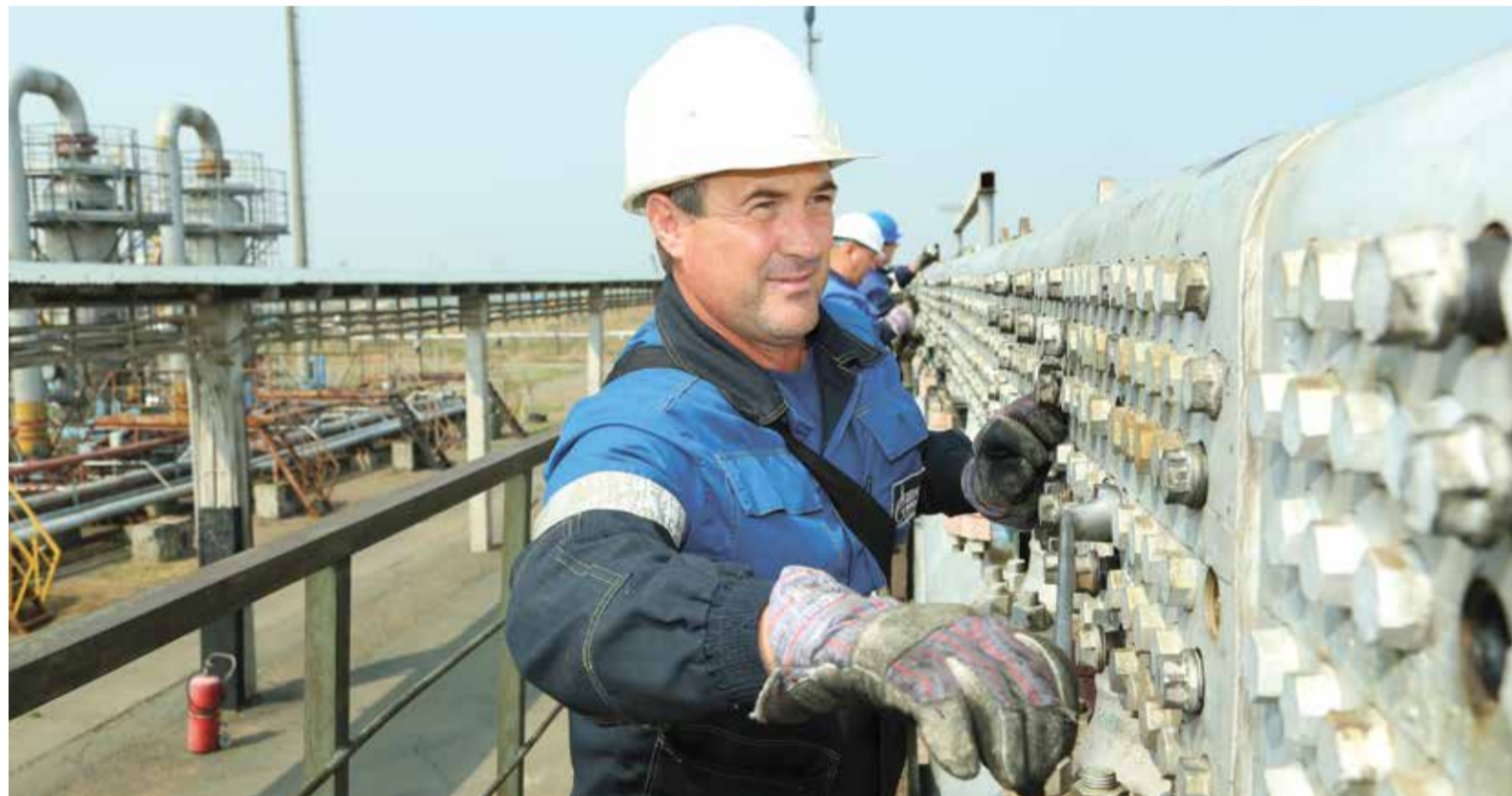
Слесарь по ремонту технологических установок Сергей Гусь монтирует заглушки на электроприводном газоперекачивающем агрегате
