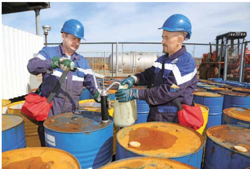
Слесари по ремонту технологических установок газопромыслового управления Леонид Черняков (слева) и Евгений Востров ведут отбор масла для замены на насосе по перекачке водно-метанольной смеси. На заднем плане — емкость для хранения стабильного конденсата
