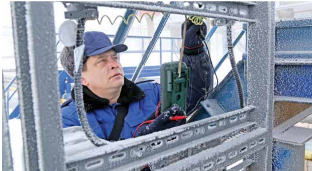
Приборист Александр Голосков проверяет заземление оборудования
