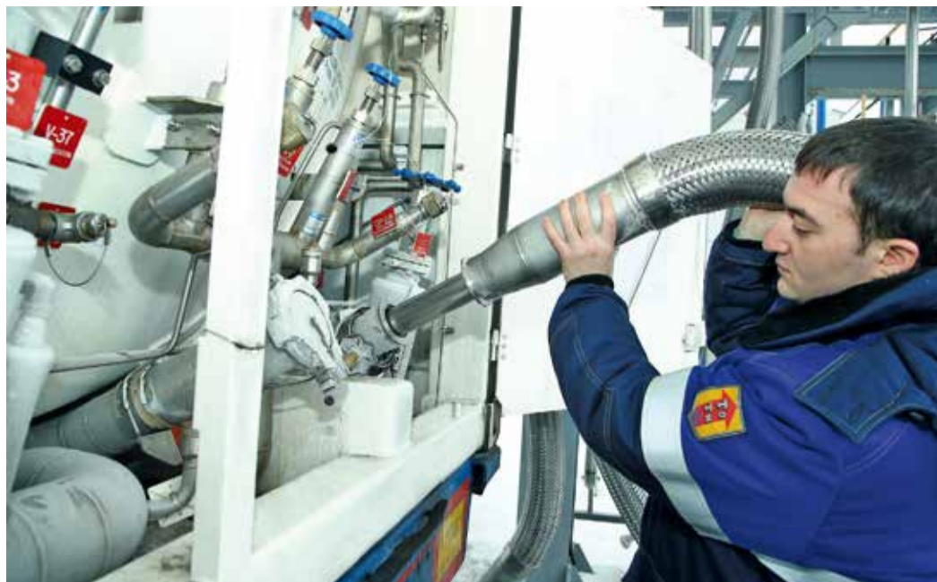
Машинист технологических установок Артур Айткулов подключает металлический рукав к контейнеру
