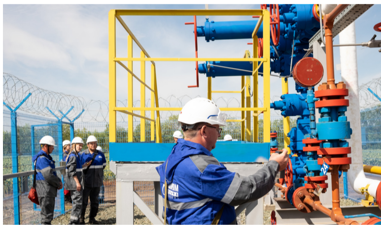
Идущая справа белая труба не покрашена в белый цвет, она во льду. На скважине, где поднимающийся с глубины под большим давлением газ надо перевести на меньшее давление, проявляется эффект Джоуля-Томсона.
